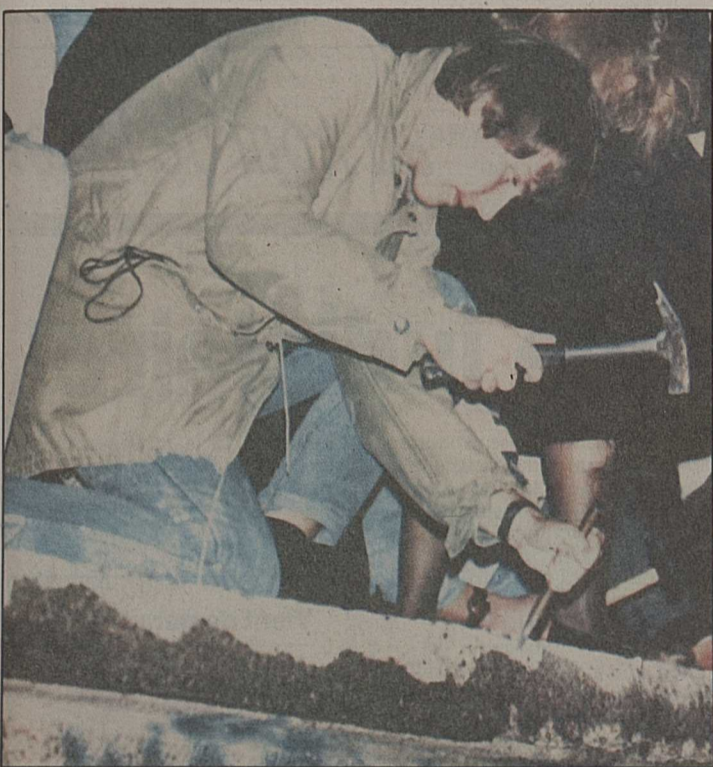
Il semble que certains Berlinoises ne se satisfont pas des «trous» officiels percés dans le mur! Plusieurs jeunes gens, armés de marteaux et de burins ont entrepris de raser la honteuse construction (ci-dessus). Ci-contre, vendredi matin, des scènes d'enthousiasme et d'euphorie à la frontière entre les «deux Berlins»... AP
