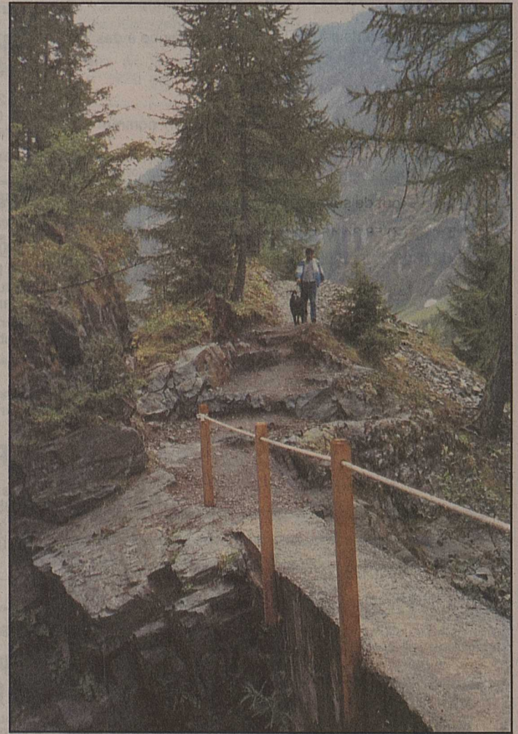
Amélioration qualitative du chemin reliant Van-d'En-Haut à Salanfe dans le tour des Dents-du-Midi.
