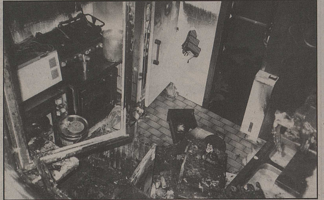
La cuisine est complètement détruite.
