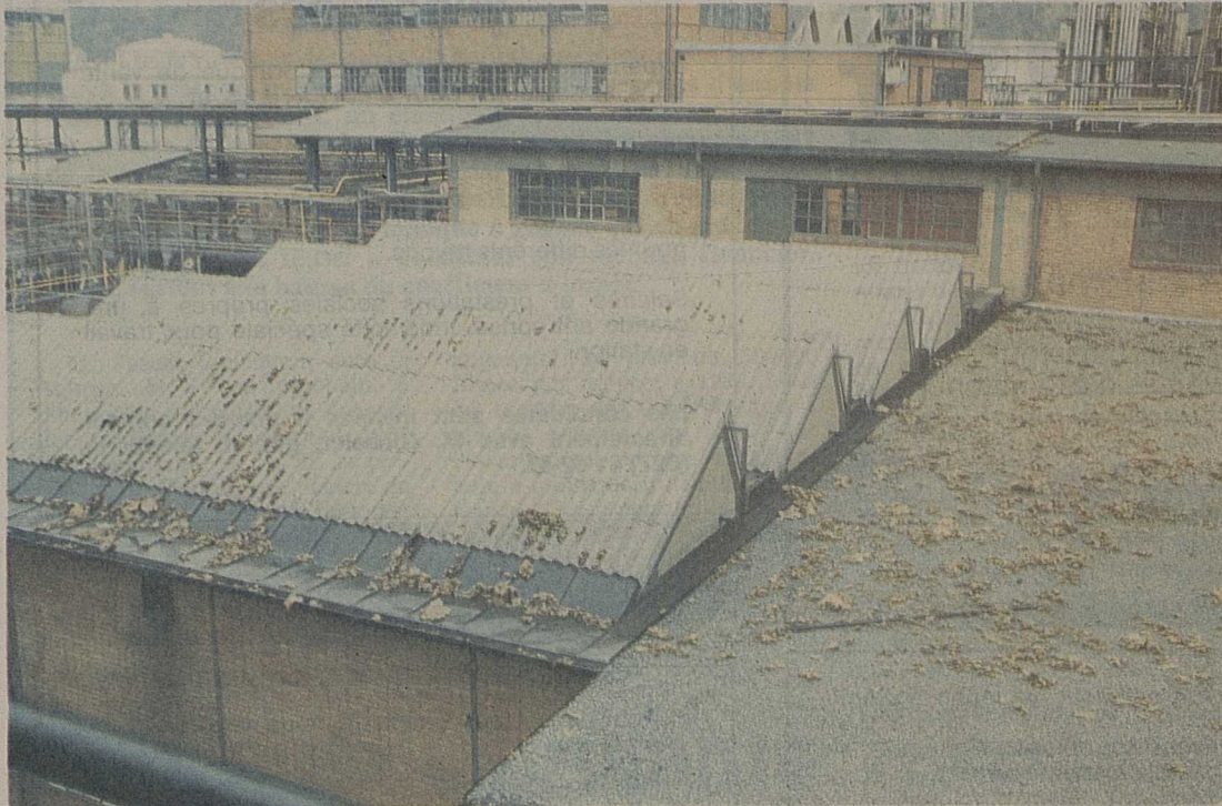
Les pompiers de l'usine se sont rendus maîtres de la situation en quelque vingt minutes. On remarque quelques déchets sur les toits de l'usine. Le nuage de vapeur qui s'est élevé au-dessus de Viège n'a pas manqué d'inquiéter la population.
