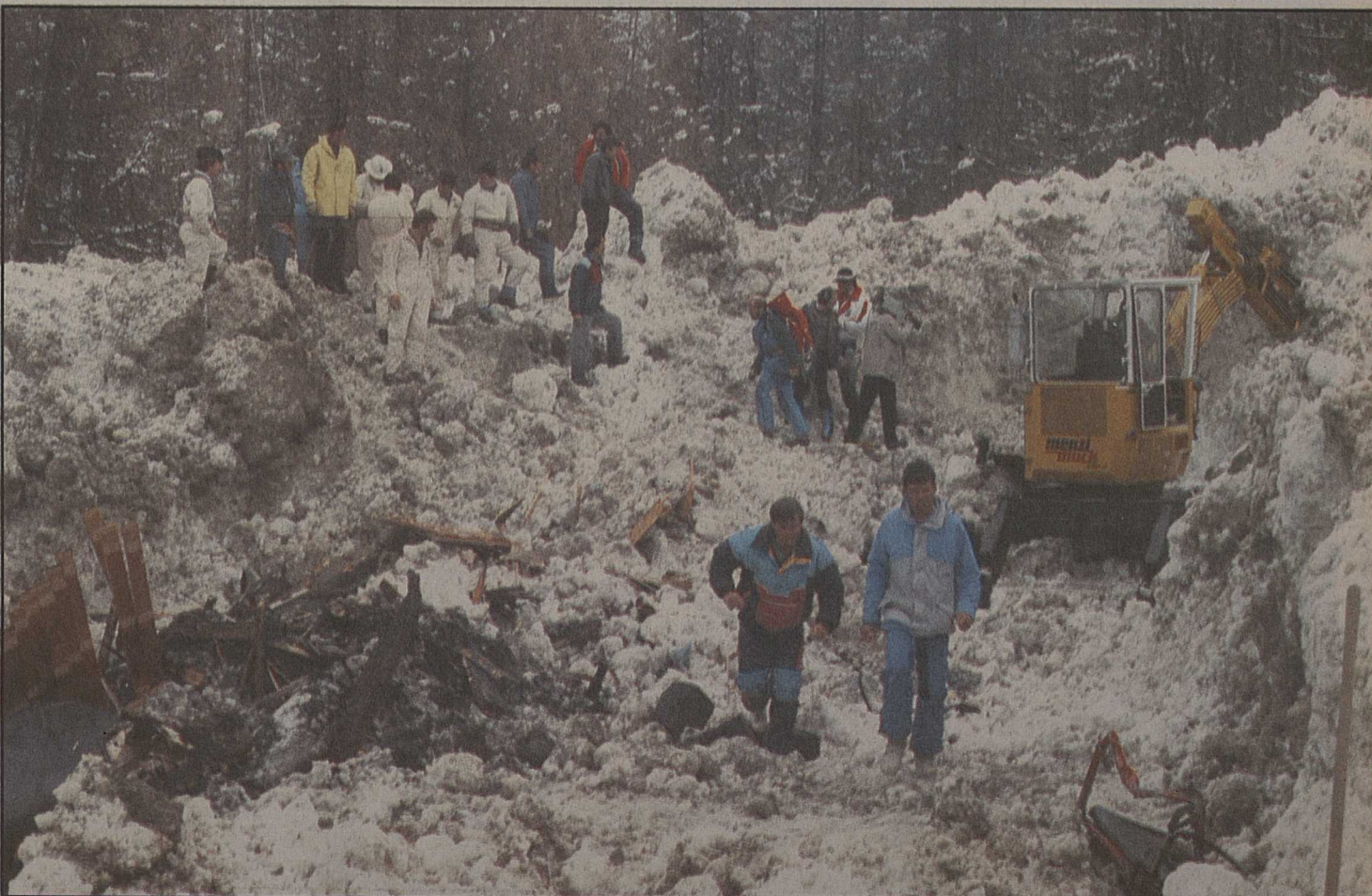
Les sauveteurs creusent la neige pour atteindre le «bunker» où le propriétaire se réfugiait occasionnellement en cas de danger. Il faudra dégager des tonnes de neige, défoncer une porte à la tronçonneuse, avant d'atteindre ce local. Hélas, la victime ne s'y trouvait pas...
