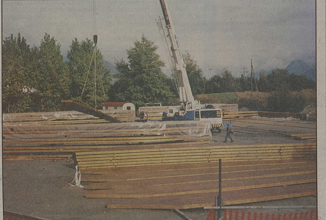
Actuellement, sur une des places de parc de Tourbillon, les éléments de bois sont préparés pour le montage.
