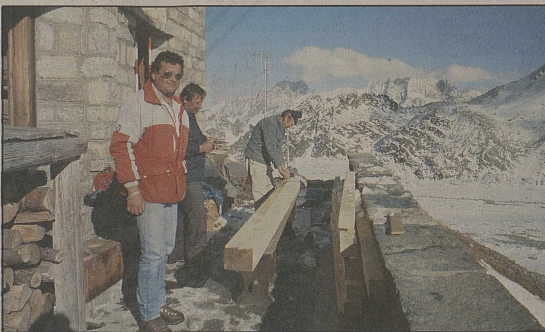
Les ouvriers de l'entreprise Mauris, taillant sur place les poutres de la nouvelle toiture.
