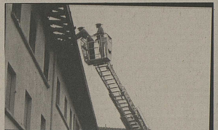
Les pompiers, à l'aide de la grande échelle, débarrassent les tuiles du toit qui a été en partie brûlé, afin d'éviter des accidents.
