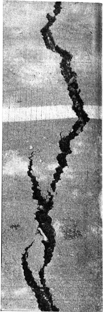
La fissure telle qu'elle se présentait jeudi après-midi, sur une dizaine de mètres, à environ deux mètres du bord du lac.
