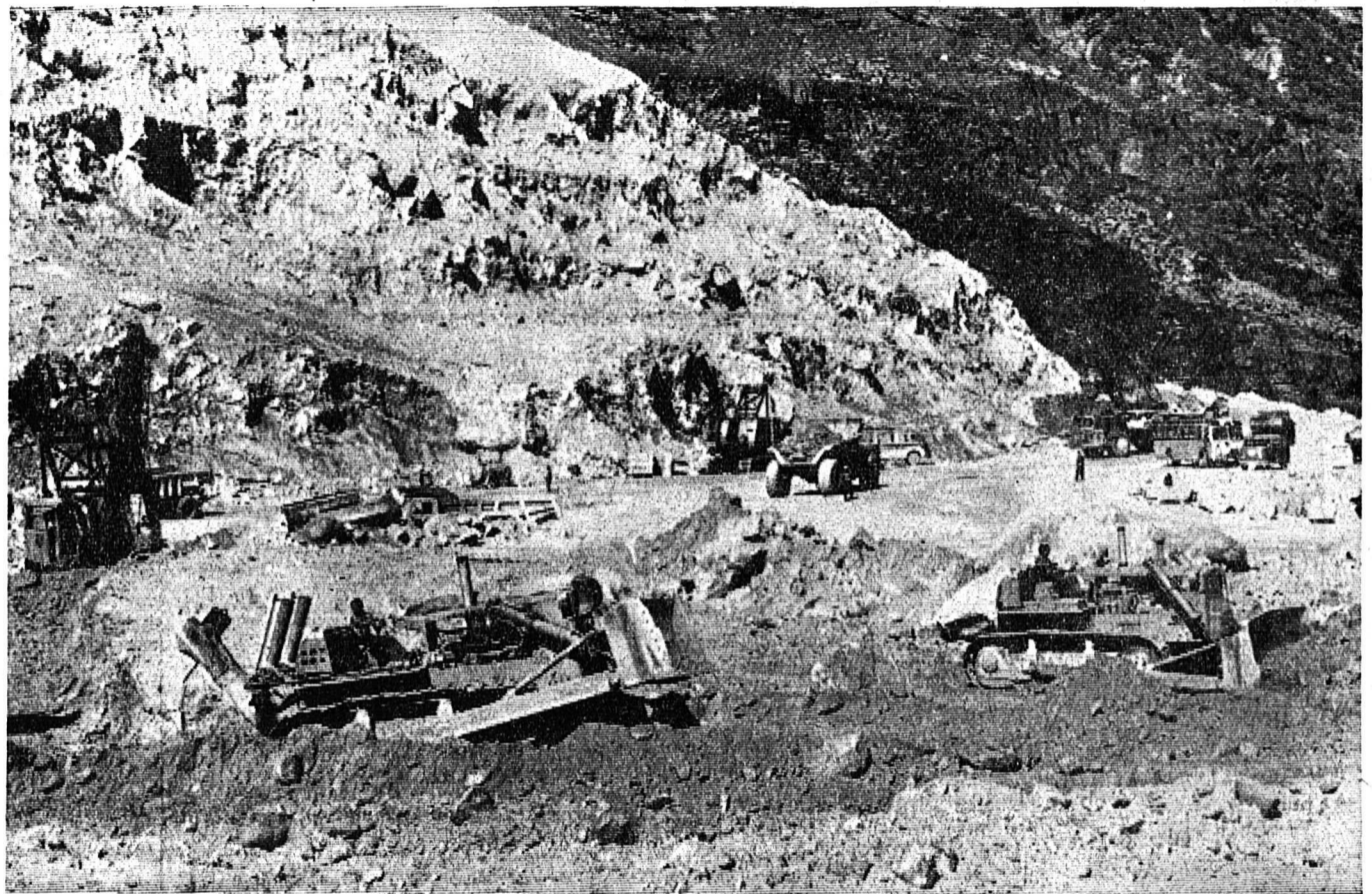
Jour et nuit les trax dévorent la moraine pour alimenter le barrage-digue.
