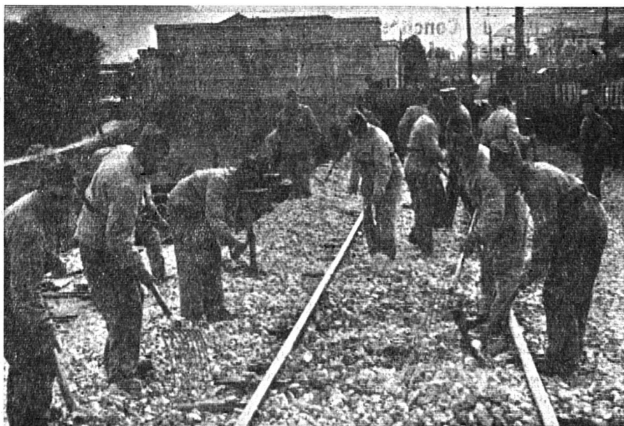
SIERRE. — Un détachement de services complémentaires est actuellement en service à Sierre. Les hommes sont occupés au déplacement des voies de chemin de fer.
