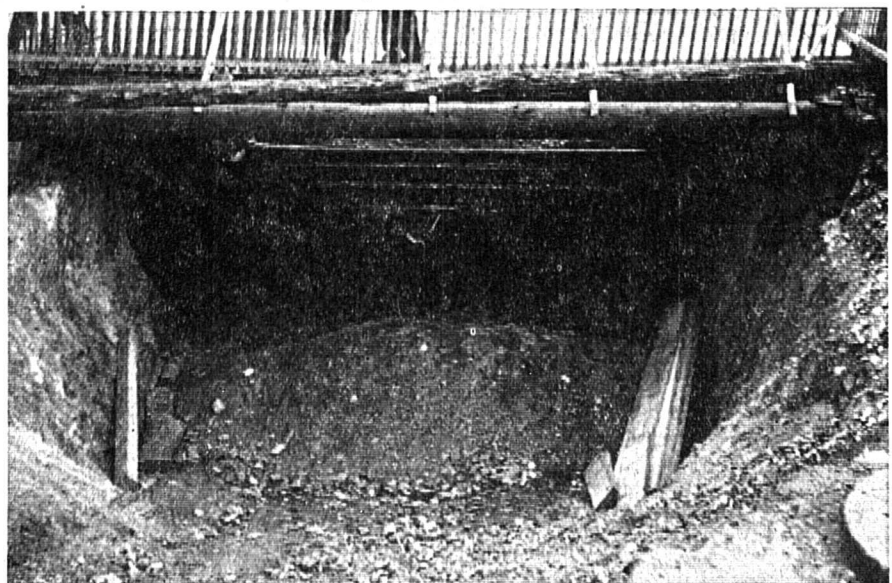
SIERRE. — Dans le cadre de l'extension de la gare de Sierre, un passage sous-voies est actuellement en construction. L'ouvrage aura une largeur de 4 m. 50, ce qui permettra aux usagers de quitter la gare sans encombre.
