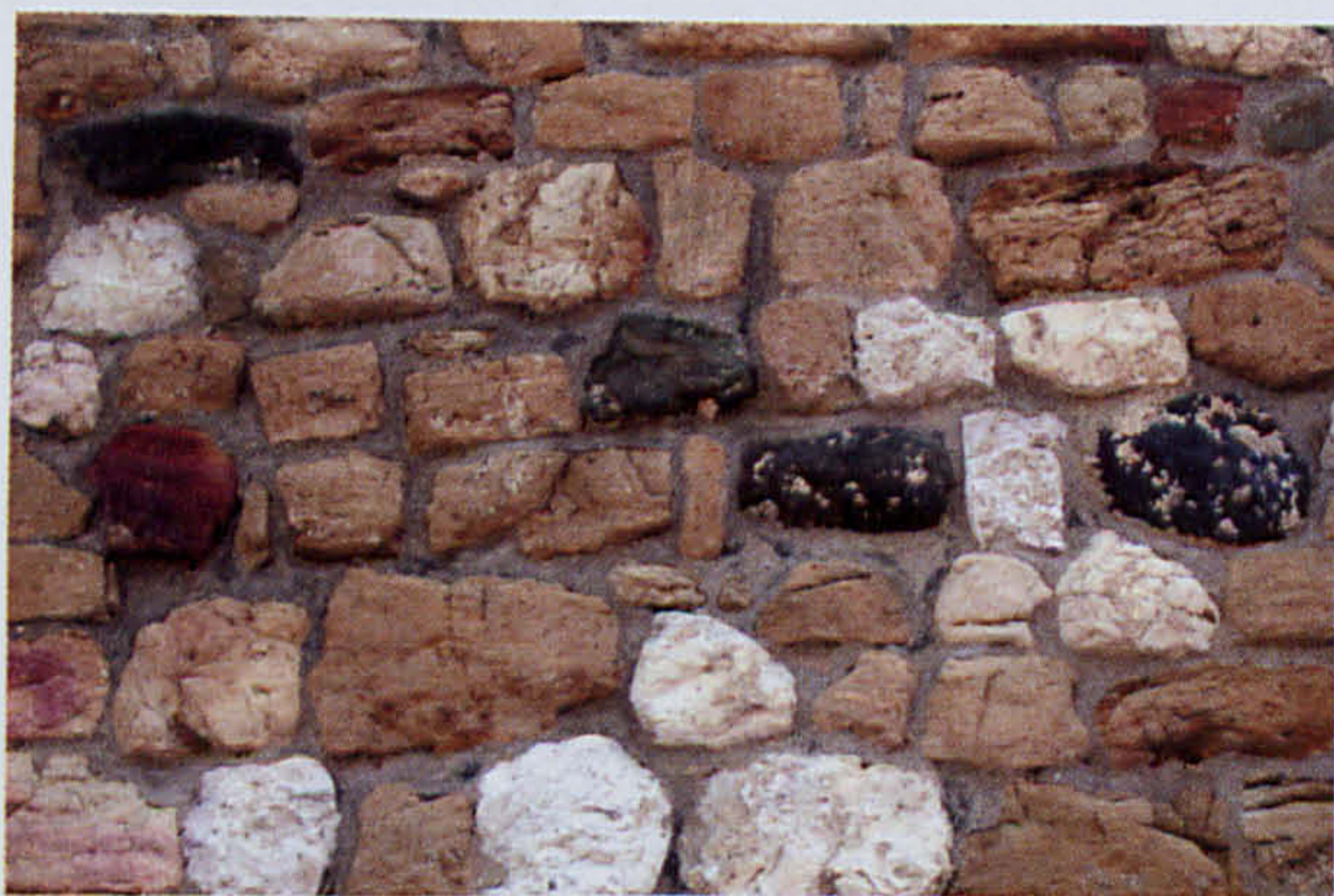
Planche 4C : Variété pétrographique dans le bas du rempart ouest du château de Neuchâtel. La Pierre Jaune domine (parfois rougie par le feu), mais se trouve mêlée à des blocs de calcaires blancs (Roc) et de l'erratique (divers types de Roches vertes de la rive sud de la Vallée du Rhône mais pas de quartzites ni de calcaires alpins).
