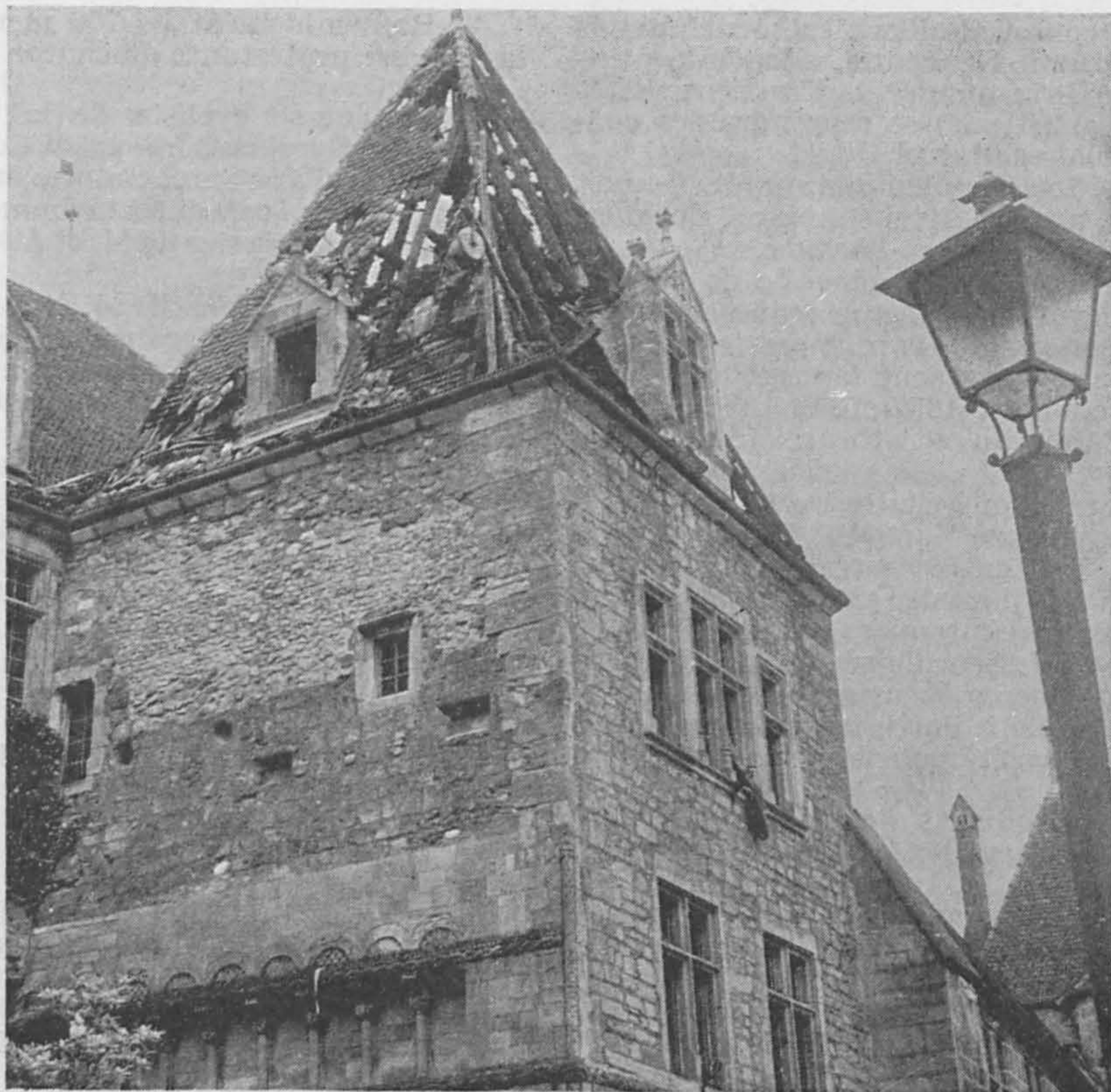
L'état de la tour romane du château de Neuchâtel après l'incendie du 1 er mai 1959.
