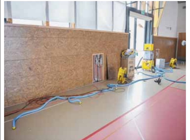
Des pompes et des aspirateurs ont été installés pour résorber les dégâts dus à la rupture d'une conduite d'eau. CHRISTIAN GALLEY
