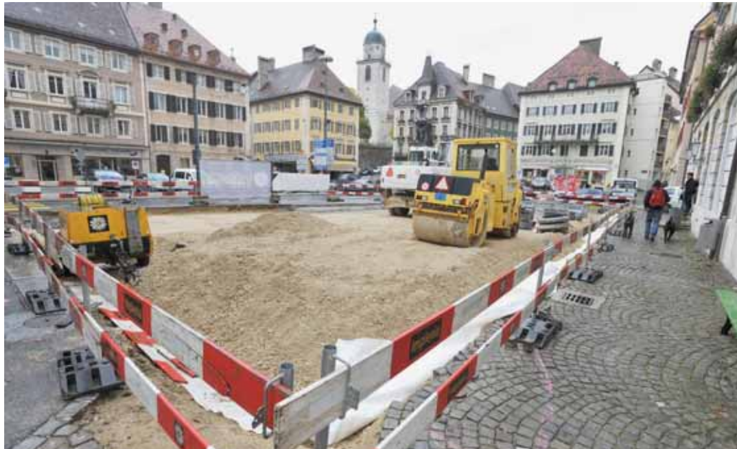
Le chantier de la place de l'Hôtel-de-Ville a commencé lundi dernier et se terminera à mi-novembre.
