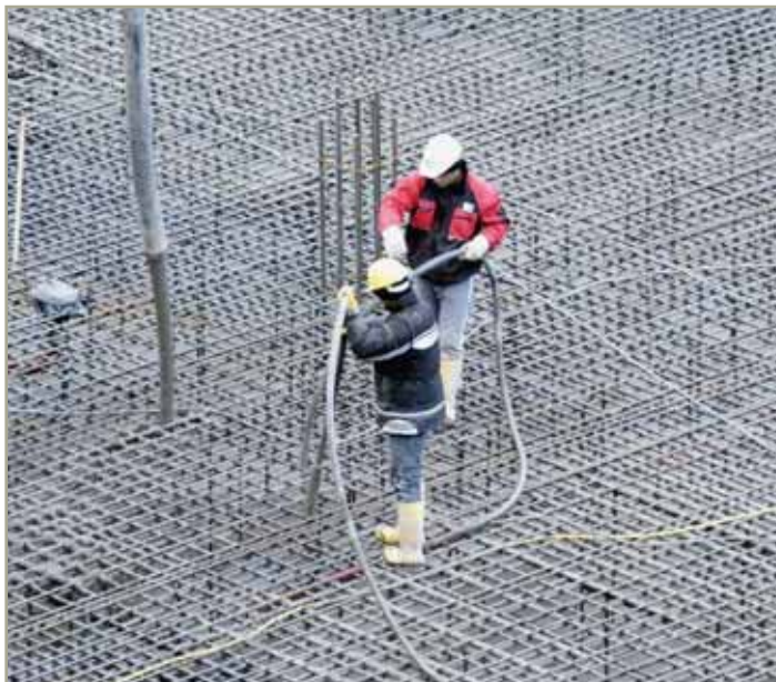
Un léger tassement, mais pas vraiment de resserrement de l'activité en vue sur les chantiers. KEYSTONE
