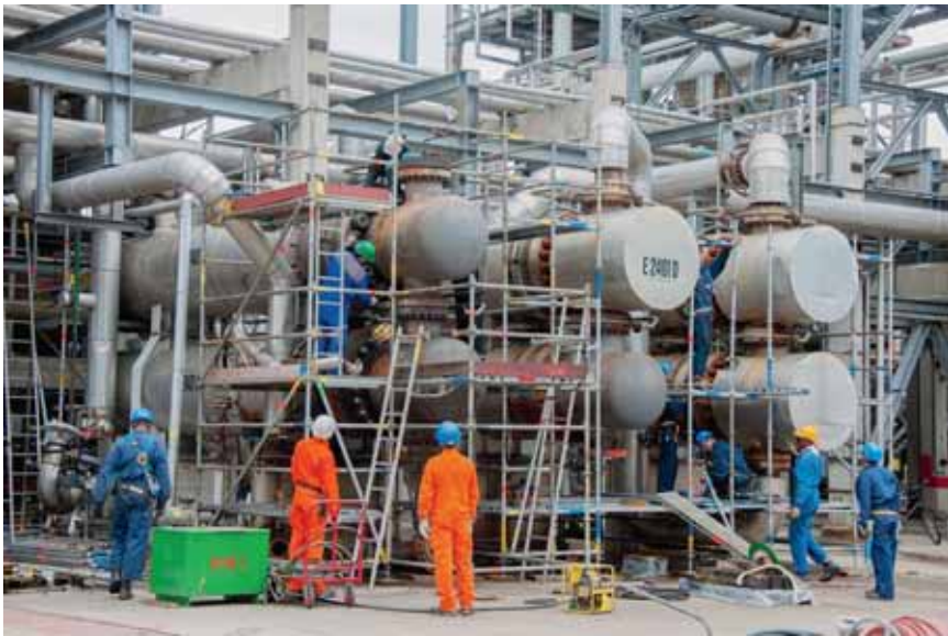
La maintenance n'a jamais cessé sur le site de Cressier.
