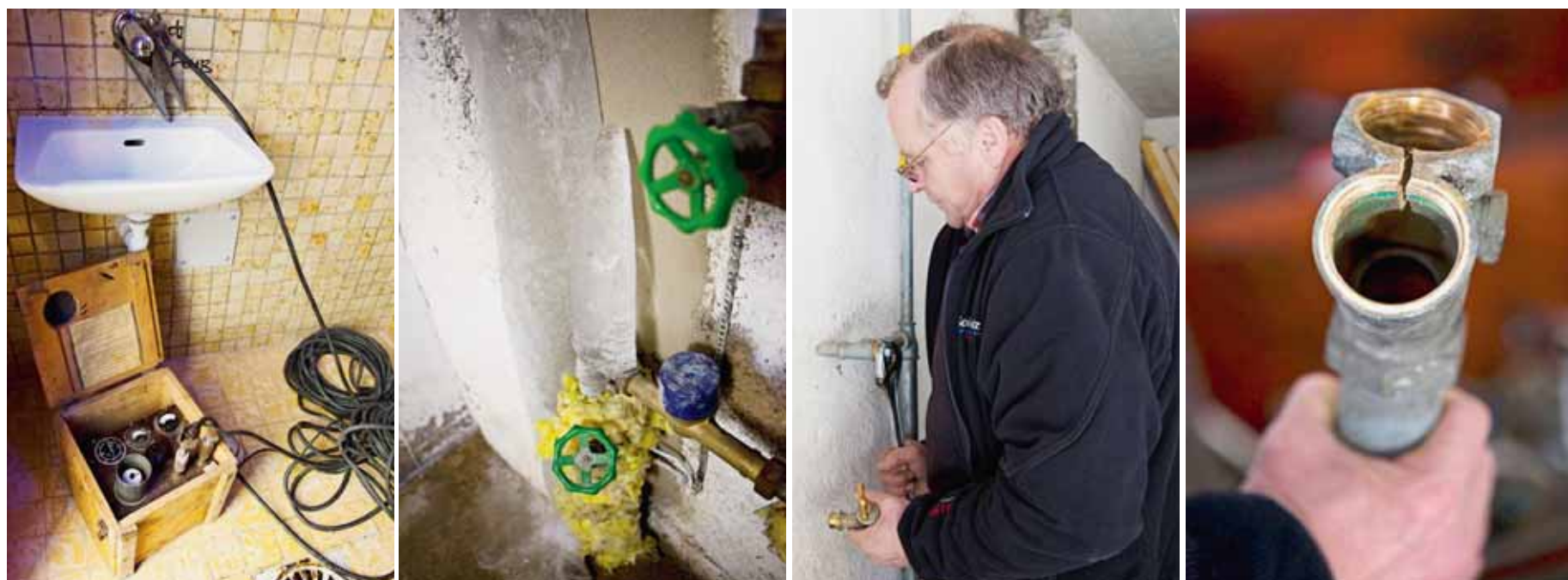
Les tuyaux dans lesquels l'eau a gelé, un problème souvent rencontré ces derniers jours par Jean-Daniel Schindelholz et son entreprise d'installations sanitaires et de chauffage. Il craint maintenant les inondations que pourrait provoquer le redoux. PATRICIA LOPEZ
