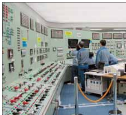
RÉACTEUR N°3 Sa salle de contrôle a été partiellement remise sous tension grâce à une alimentation externe.
