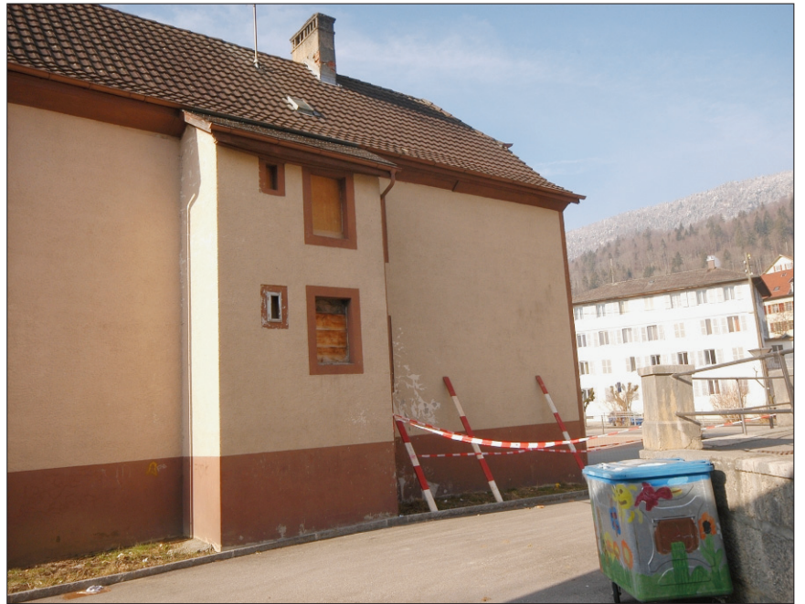
MENACE La cheminée de cet immeuble situé juste à côté de l'école a perdu des morceaux de briques et de crépis. Les autorités ont pris des mesures. (BLAISE DROZ)
