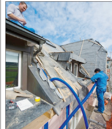
RUE NEUVE 9 L'état des travaux d'assainissement à fin septembre. (ARCHIVES DAVID MARCHON)
