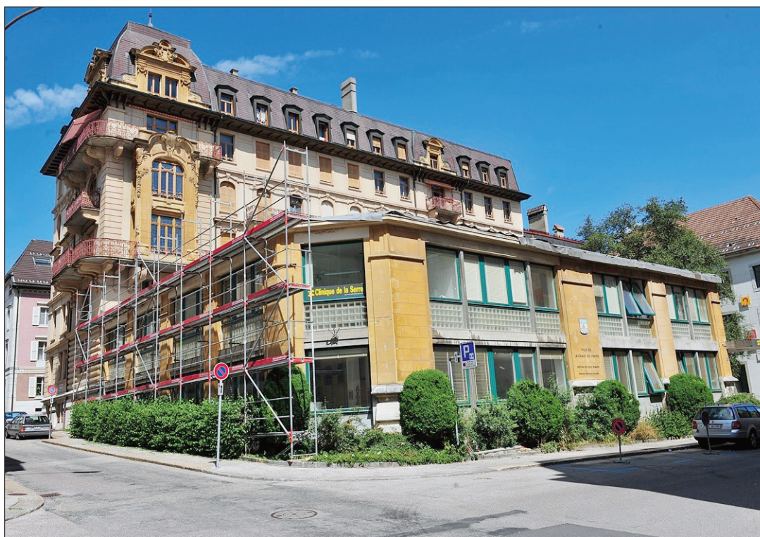
SERRE 14 L'étanchéité du toit était à refaire. Mais après un incendie dû à une négligence, on a découvert une dalle en béton en mauvais état qui nécessite une intervention urgente.
