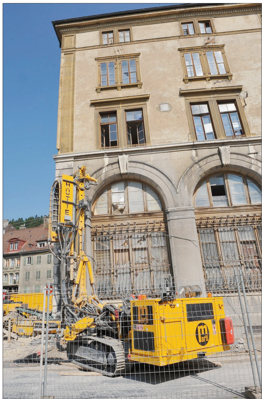
EN PLEINE ACTION Pour la stabilisation de l'Ancienne Poste, on y va par micropieux qui descendent à 15 mètres de profondeur. Des travaux complexes. (RICHARD LEUENBERGER)
