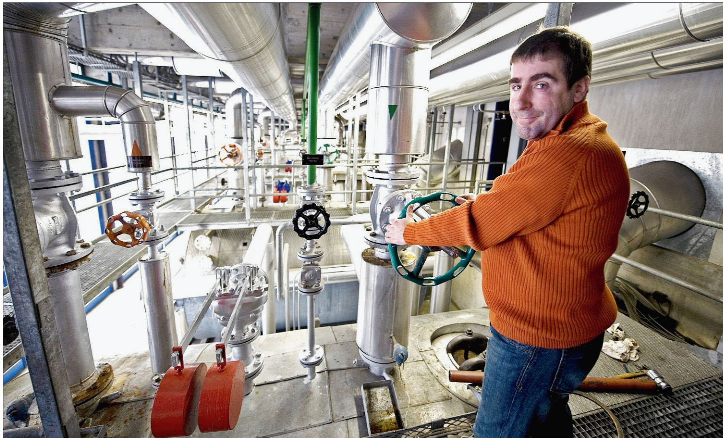
INCIDENT «EXCEPTIONNEL» La centrale de chauffe de la Maladière, située au nord du CPLN, s'est arrêtée samedi à 3h30 du matin. Frédéric Sapin et son équipe d'intervention ont travaillé 30 heures d'affilée pour localiser et réparer la conduite d'eau qui a cédé.
