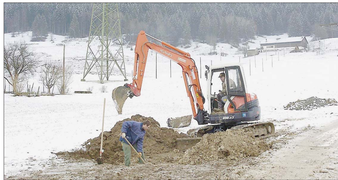
TROU SOUS LA CHAUSSÉE Le vide a été rapidement comblé et la route rouverte. Les travaux visant à drainer l'eau infiltrée et à remplacer la conduite défectueuse se poursuivent. (RICHARD LEUENBERGER)
