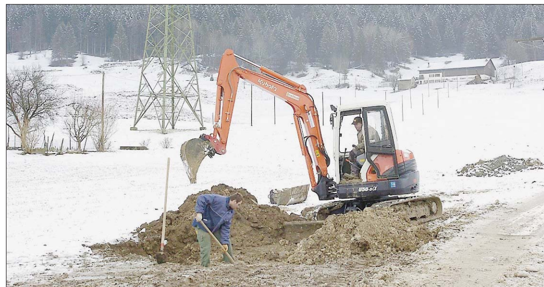
TROU SOUS LA CHAUSSÉE Le vide a été rapidement comblé et la route rouverte. Les travaux visant à drainer l'eau infiltrée et à remplacer la conduite défectueuse se poursuivent. (RICHARD LEUENBERGER)
