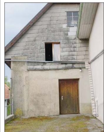
FAÇADE OUEST EN ÉTERNIT Elle nécessite de gros travaux. (SP)
