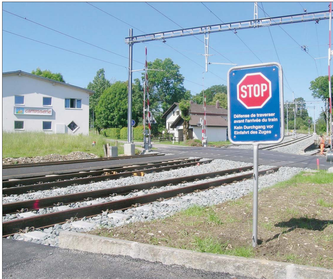
DES BARRIÈRES AVANT UN SOUS-VOIE Les travaux de réaménagement de la gare CJ des Reussilles n'ont pas attendu tous leurs feux verts pour être engagés. (PHILIPPE CHOPARD)
