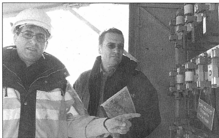
Valerio Maj, responsable construction & entretien, et Claude Comte, responsable sponsoring, devant l'armoire de la station transformatrice de Petit-Martel, montrent l'étiquette annonçant que le courant a été coupé: il s'agit d'éviter une remise en service intempestive.
