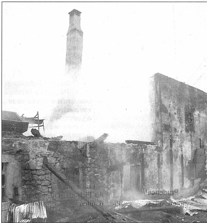
Datant de 1804, le rural n'est plus qu'une ruine. Seule la cheminée se dresse encore fièrement.
