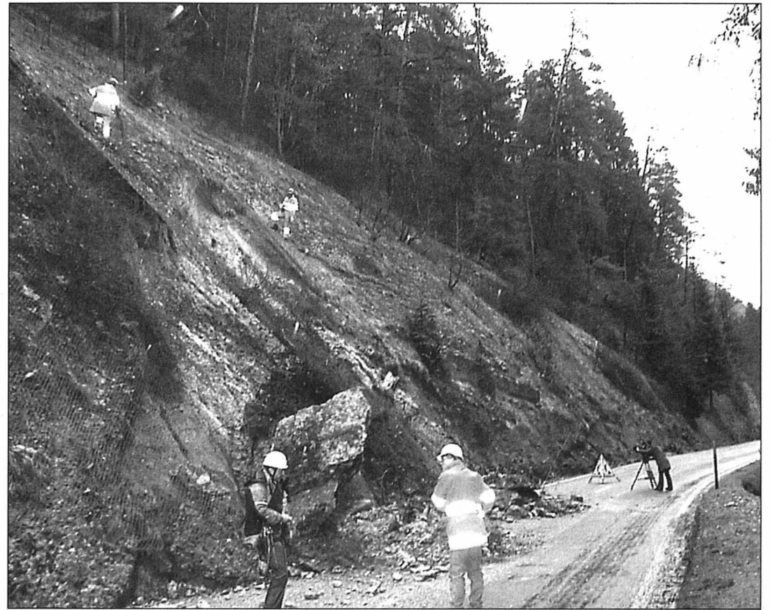
Hier à l'aube, la roche qui s'est abattue sur la chaussée a démolie une voiture, heureusement sans blesser son conducteur.
