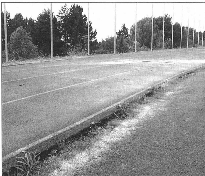
Les rectilignes de la piste sont déchaussés par un drainage insuffisant.
