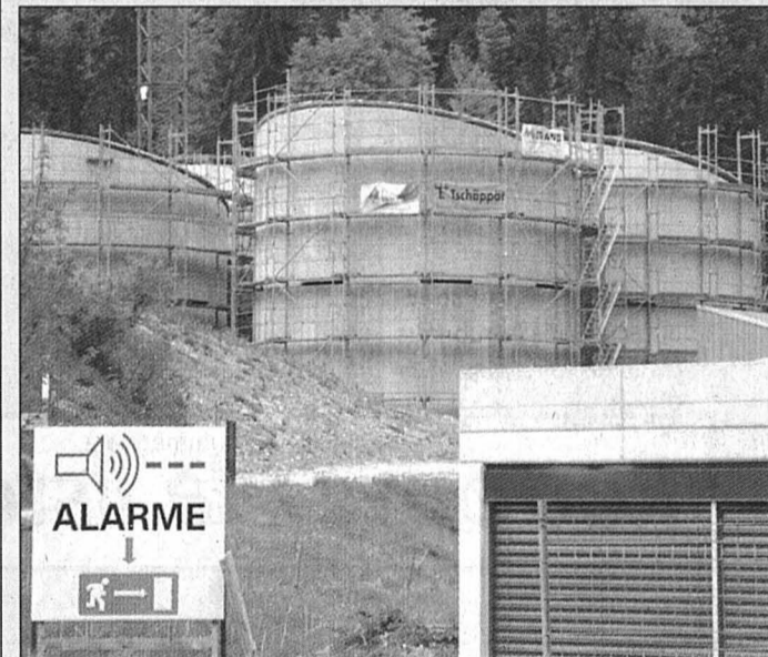
La Chaux-de-Fonds investit 30 millions de francs pour rénover la step. PHOTO ARCH-LEUENBERGER
