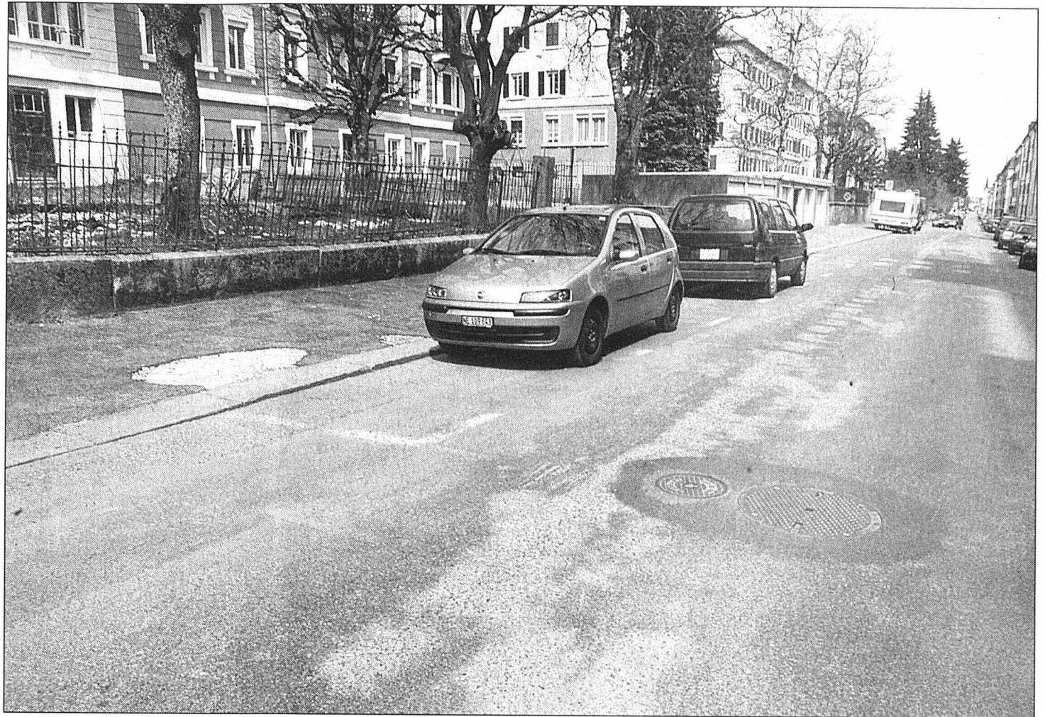
Rue du Temple-Allemand, le mauvais état de la chaussée se voit à l'œil nu.
