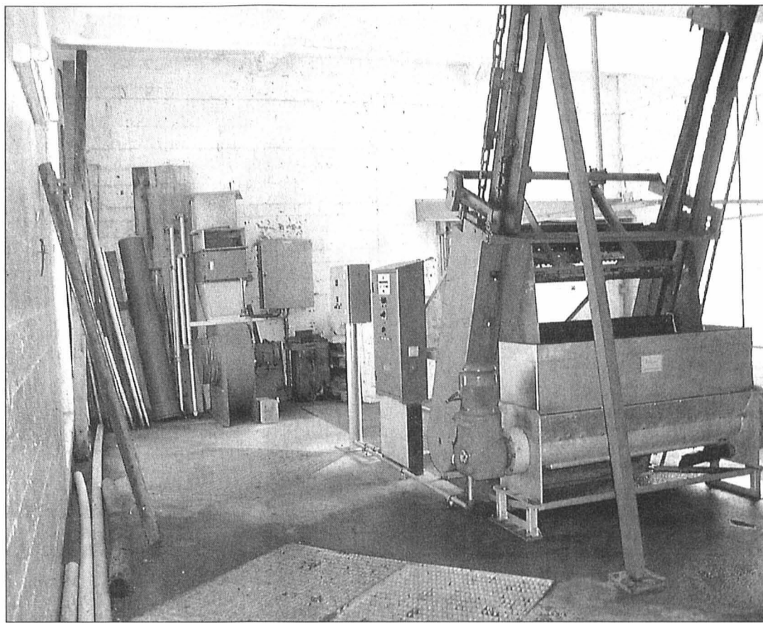
Le local, dans un triste état avec des murs intérieurs couverts de glace en hiver, abrite le dégrilleur grossier. Machine et bâtiment doivent être revus. PHOTO PERRIN
