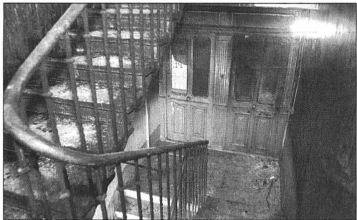
Le feu a détruit entièrement l'appartement. La cage d'escalier n'a pas été épargnée.
