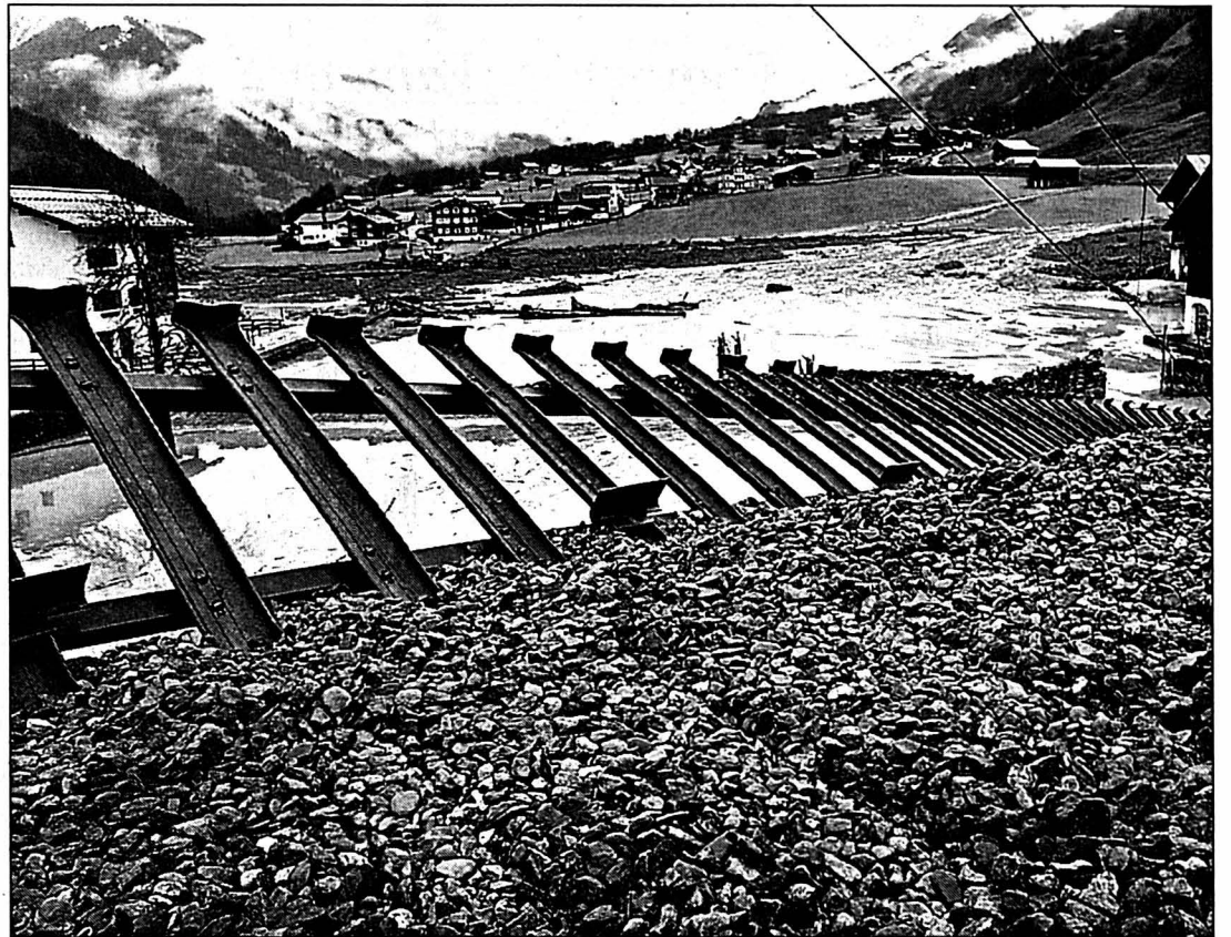
A Rueun, la boue a soulevé les voies de chemin de fer. PHOTO KEYSTONE
