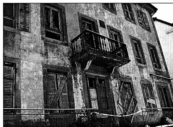
Des fenêtres brisées, des cadres de fenêtre qui pendent.
