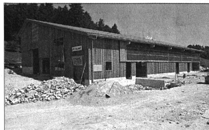
Le rural est quasi terminé, mais il reste à construire la maison d'habitation.
