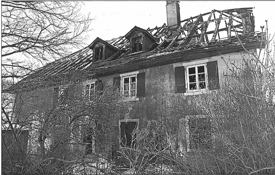
L'immeuble est inhabitable malgré une prompt intervention des pompiers. PHOTO GALLEY
