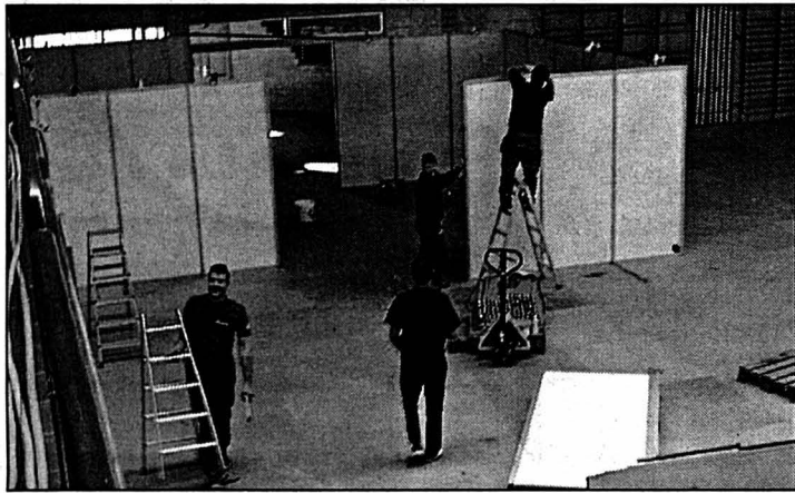
Hier à la halle polyvalente, les panneaux de séparation en plein montage. PHOTO PERRIN
