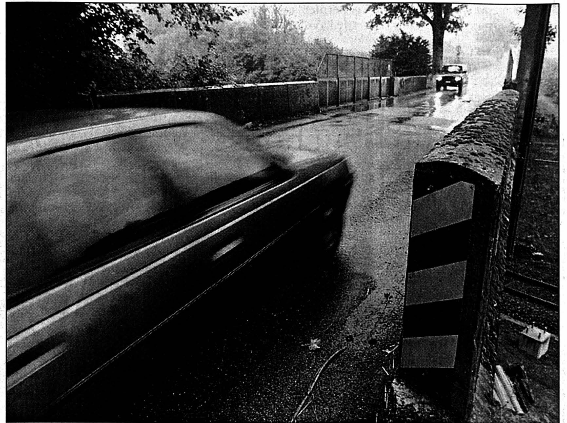
Le pont de Montmollin sera dépouillé de ses deux parapets en pierre, devenus dangereux, et de sa chaussée actuelle. PHOTO MARCHON
