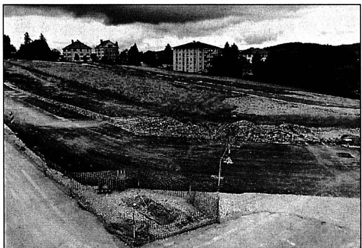
Aux Alérac, les routes sont prêtes, les maisons peuvent maintenant pousser. PHOTO LEUENBERGER
