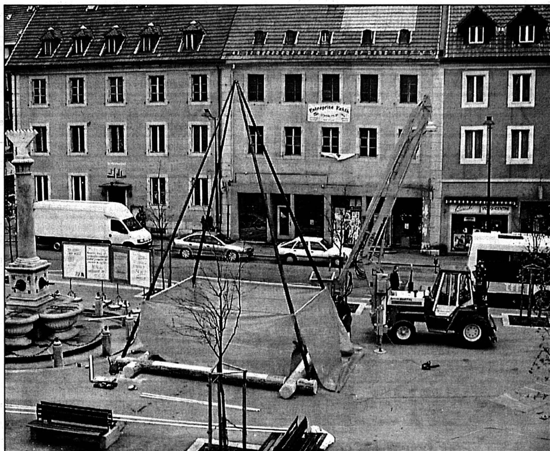
Sous l'œil étonné des Loclois, la construction du bâti, assurée par l'équipe forestière du Locle, qui servira de base à une première technologique mondiale. PHOTO PERRIN
