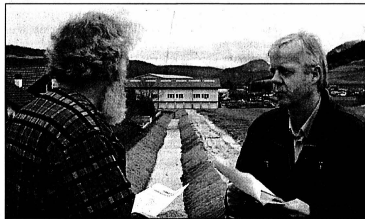
Séance de chantier entre André Beuret (à gauche), conseiller communal, et Jean Erard, ingénieur, devant le canal d'évacuation terminé.
