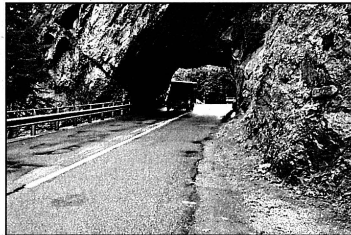
Ouvrage du XIXe siècle, le tunnel de Noirvaux a été creusé à même le rocher et laissé sans revêtement particulier. photo Béguin
