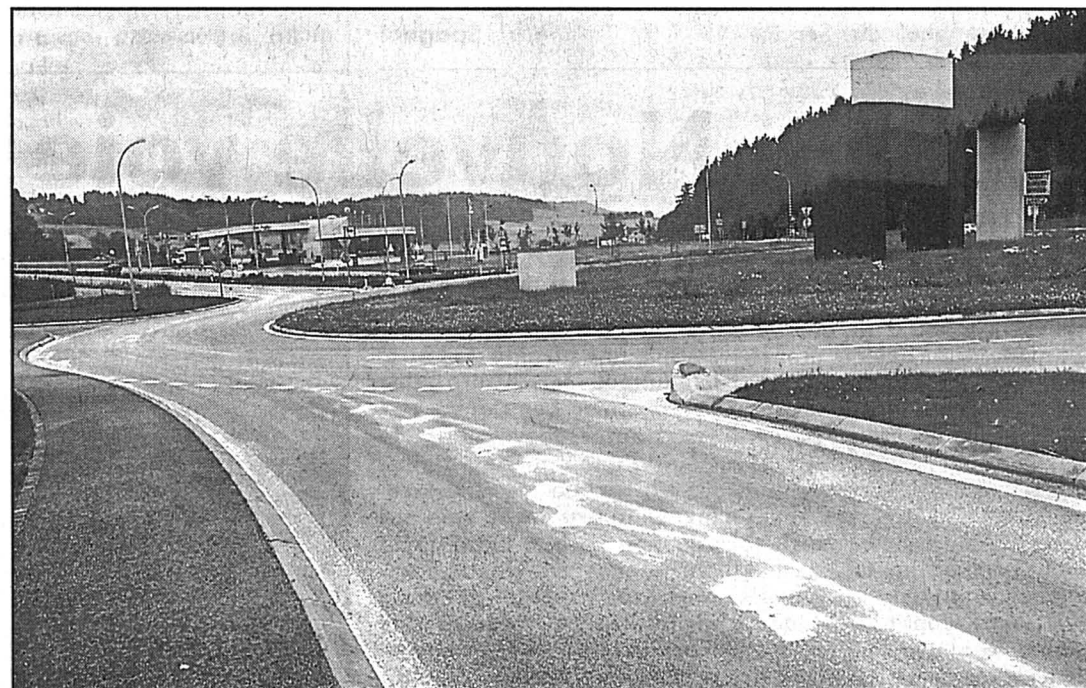
Chaussée glissante après une petite fuite de mazout ou d'essence. photo Leuenberger
