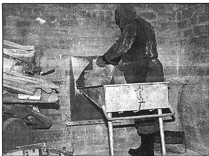
Actuellement la floculation des boues se fait encore manuellement.
