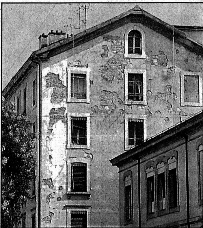
De nombreuses façades nécessitent une sérieuse rénovation.
