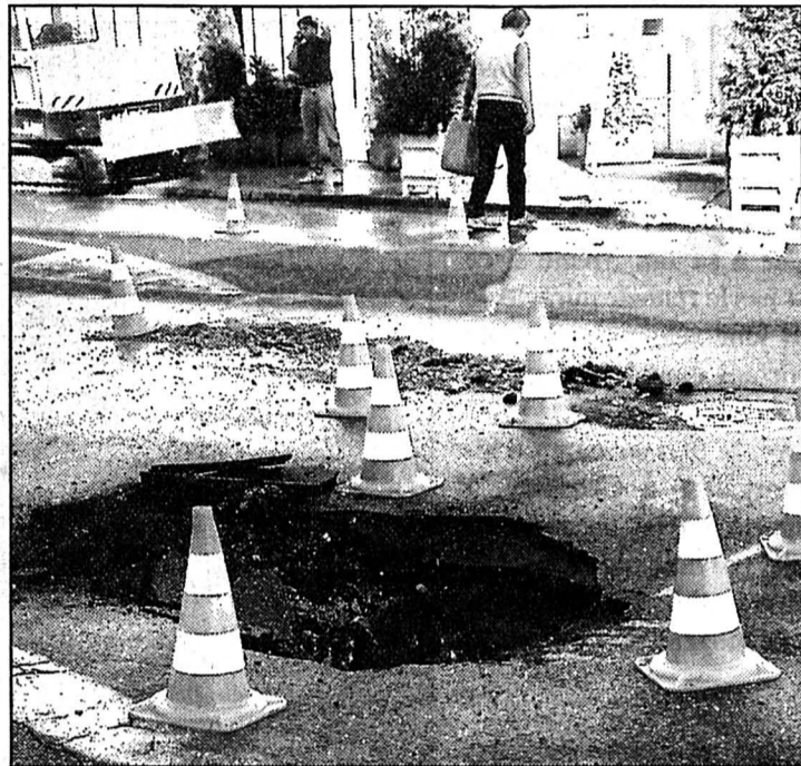
Conduite rompue et effondrement de la route C'était en juin dernier, face au restaurant de La Croisette. (Impar-Perrin-a)
