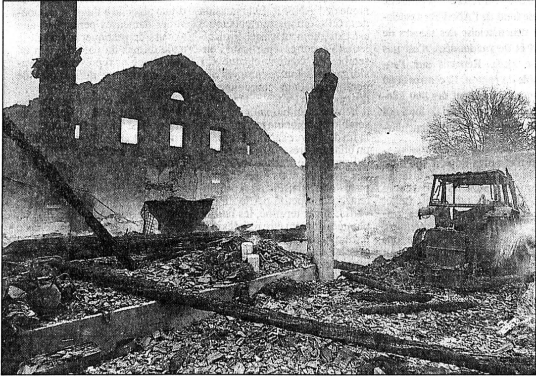
Les restes de la ferme Villiger. Seuls les quatre murs extérieurs subsistent.
