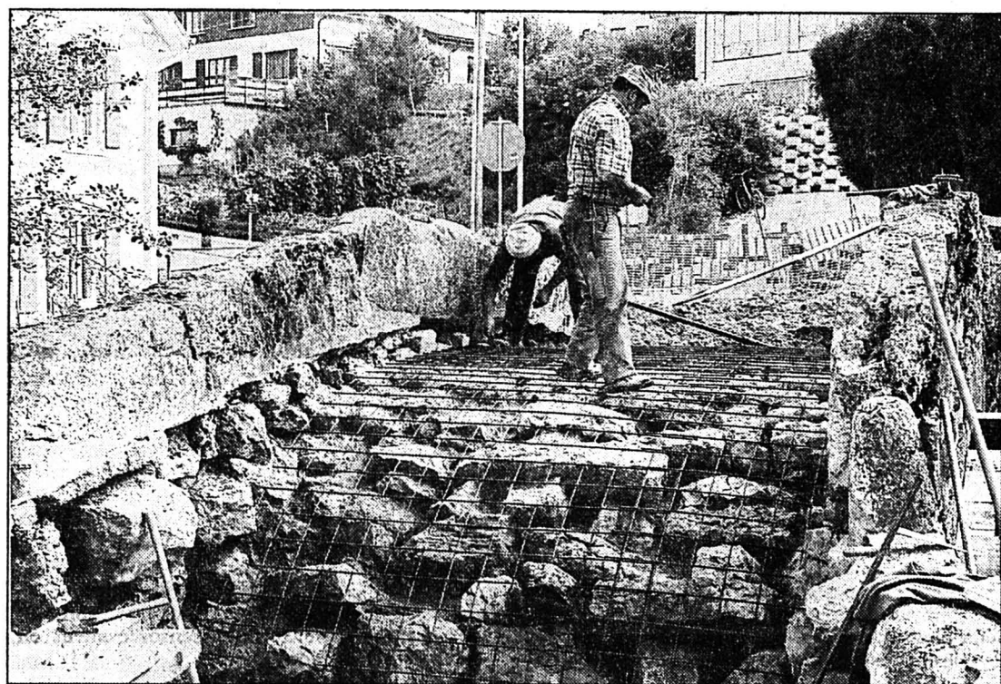
Le pont de la Crincinière. Il sera plus solide et aussi beau qu'avant. (Impar-De Cristofano)
