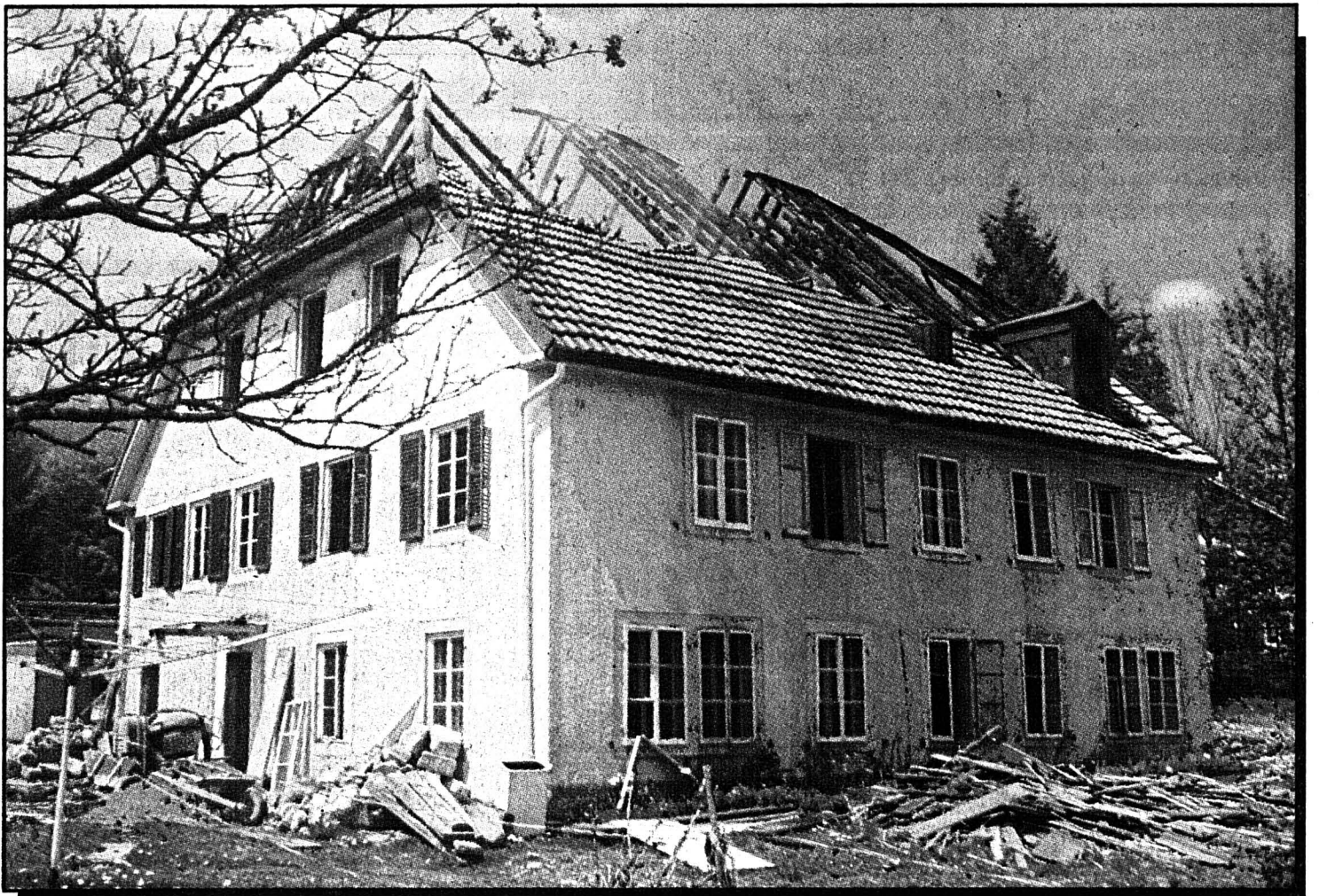
On rénove l'immeuble Monts 66: il faudra le refaire de fond en comble.
