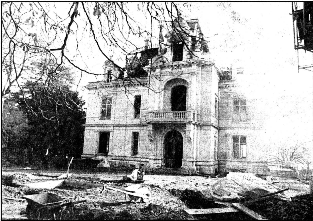
Il ne reste que les murs et les quatre cheminées.
